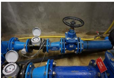
Verteiler-Rohre für Trinkwasser und Feuerwehr
